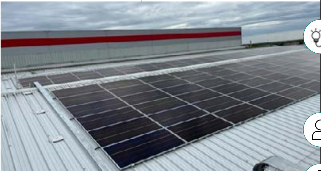
Pannelli fotovoltaici Bertolaso
